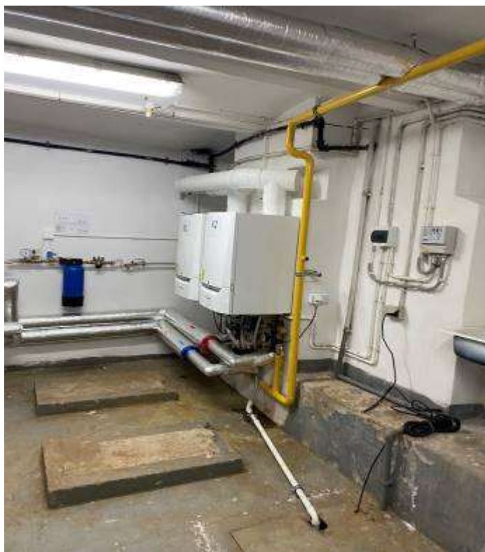
Wewnętrzna. instalacja gazowa w budynku MDK przy ul. Janasa 28- Wydział Inwestycji
