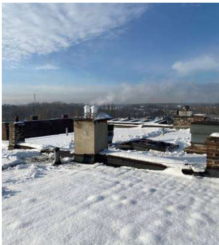
Odprowadzenie spalin w budynku MDK przy ul. Janasa 28 - Wydział Inwestycji
