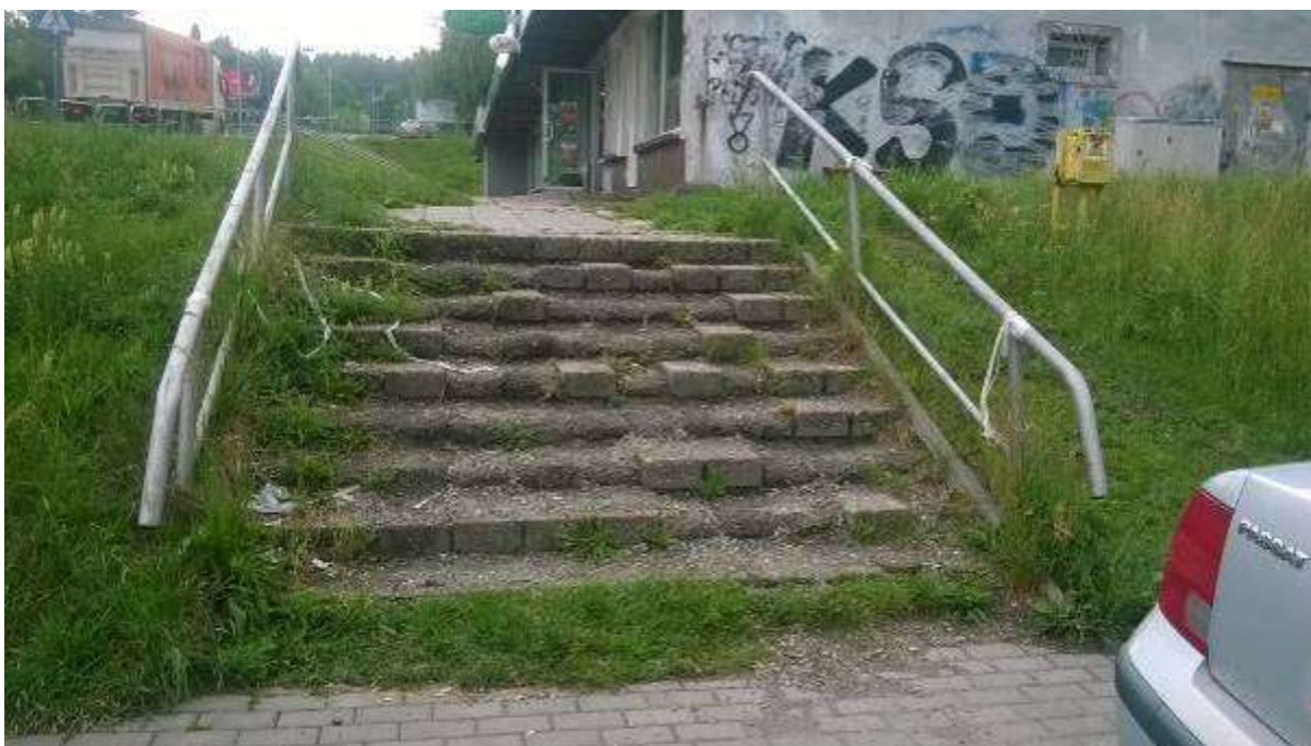
Rysunek 64. Przykład bardzo zniszczonych schodów prowadzących do pawilonu handlowo-usługowego
