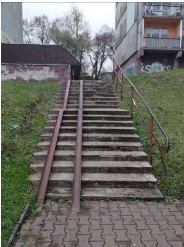
Rysunek 58. Schody za budynkiem przy ul. Gołębi
