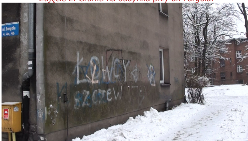
Zdjęcie 2. Graffiti na budynku przy ul. Furgoła.
