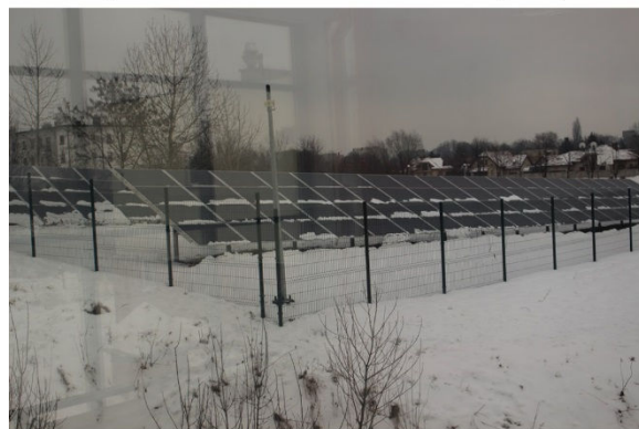
Instalacja fotowoltaiczna - basen w Rudzie
